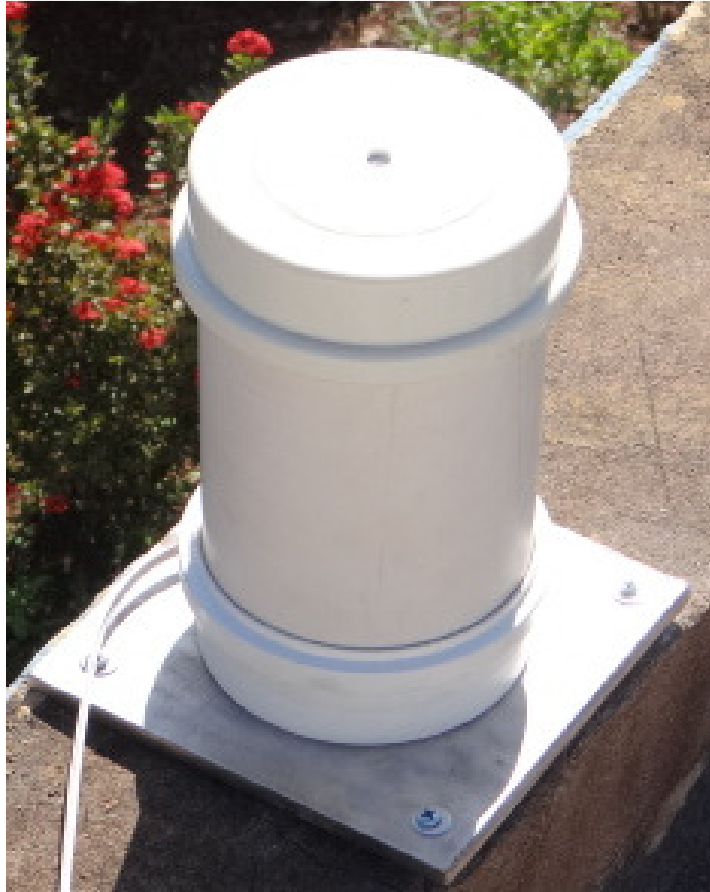
Figura 7 – Equipamento instalado sobre uma base de alumínio parafusada numa viga do telhado.
